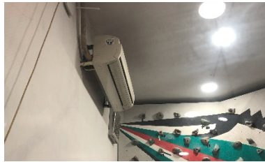
Gambar 23. AC pada area wall climb Sumber: Dokumentasi Pribadi
