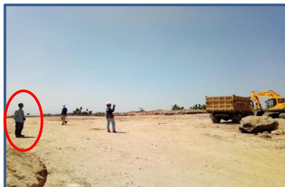
Gambar 3. Karyawan Tidak Menggunakan APD Saat Bekerja
