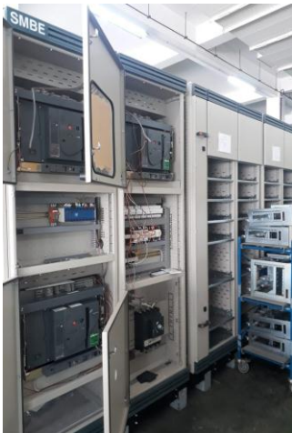
Gambar 5. Letak Pemasangan Differential Relay
