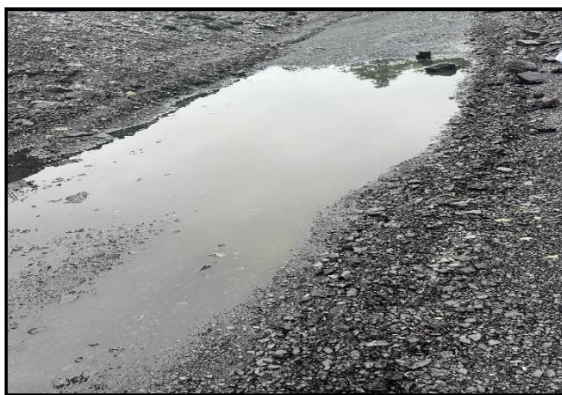
Gambar 6. Genangan air pada area stockpile
