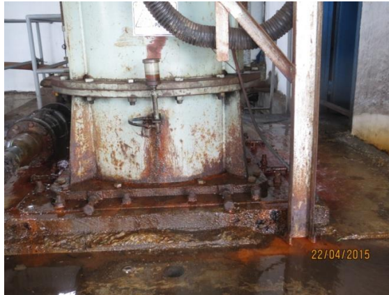
Gambar 1. Kebocoran pada pipa discharge
