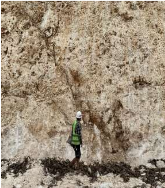
Gambar 2 : Kondisi Kemenerusan Diskontinu Pada Lereng
