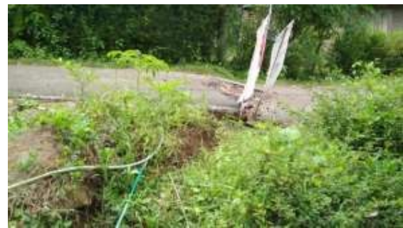
Gambar 4: Longsor yang memotong jalan di Desa Tumenggal.
