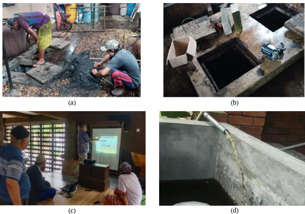
Gambar 9. (a) Pekerjaan memasukkan arang kayu ke dalam bak absorpsi, (b) Instalasi pompa di bak pengendap, (c) Pelatihan operasional IPAL-Pembangkit PV, dan (d) Uji-coba operasional alat ke Mitra 1
