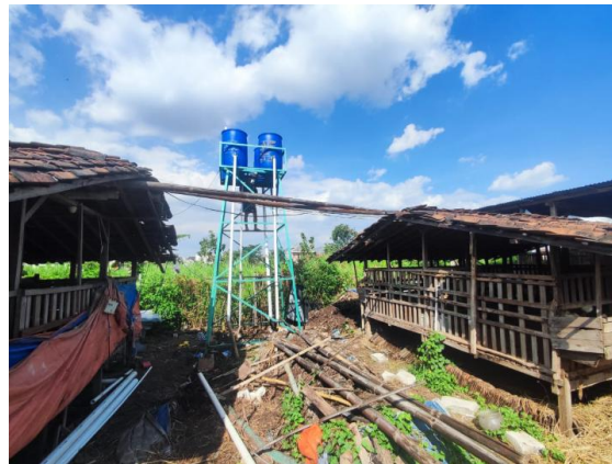
Gambar 5. Menara air yang telah terpasang dan beroperasi penuh.
